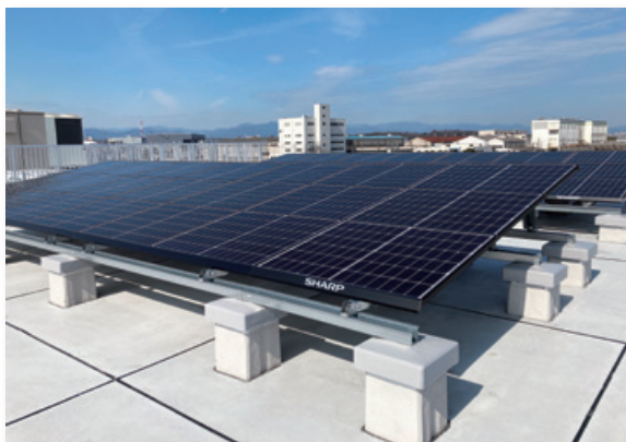
環境保全のため太陽光発電設備の設置
