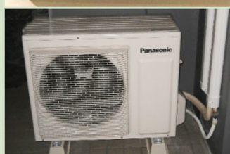
エアコン・室外機
