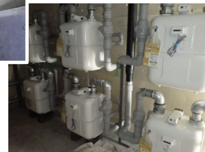
ガスメーター
